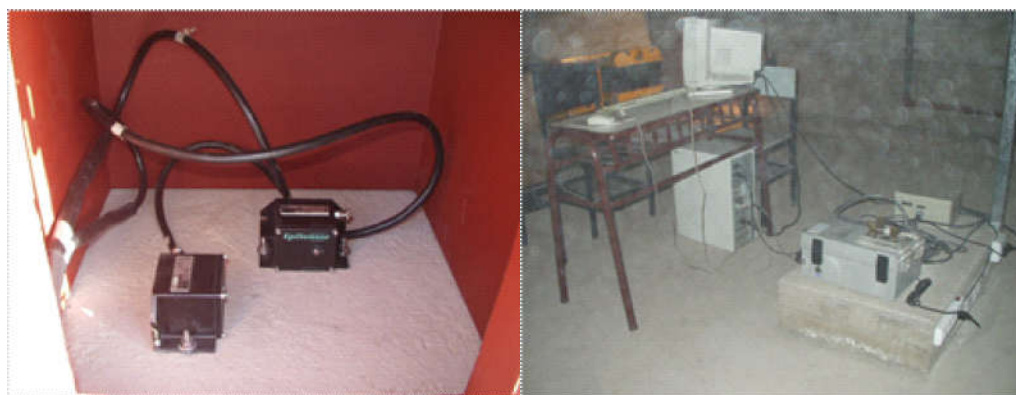
Figura 34. Instrumental sísmico instalado en el edificio aislado y en el de base fija
